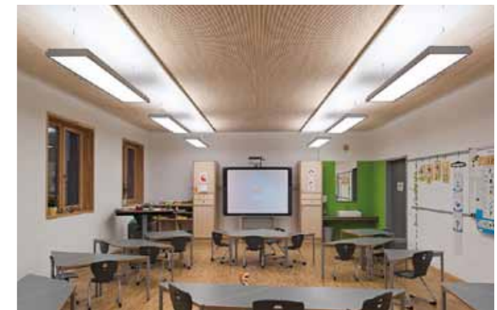
Beleuchtung der Klassenzimmer mit dynamischem Licht
