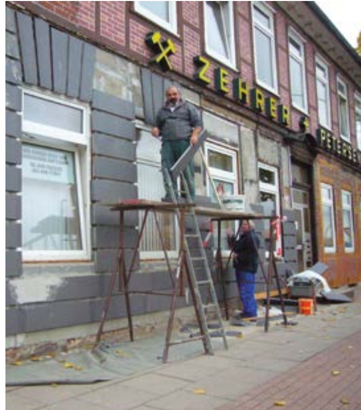
Abb. 8: Bedingt denkmalgerechte Fassadeninstandsetzung an der Harburger Schloßstraße, 2010. (Foto: Schwarzkopf)
