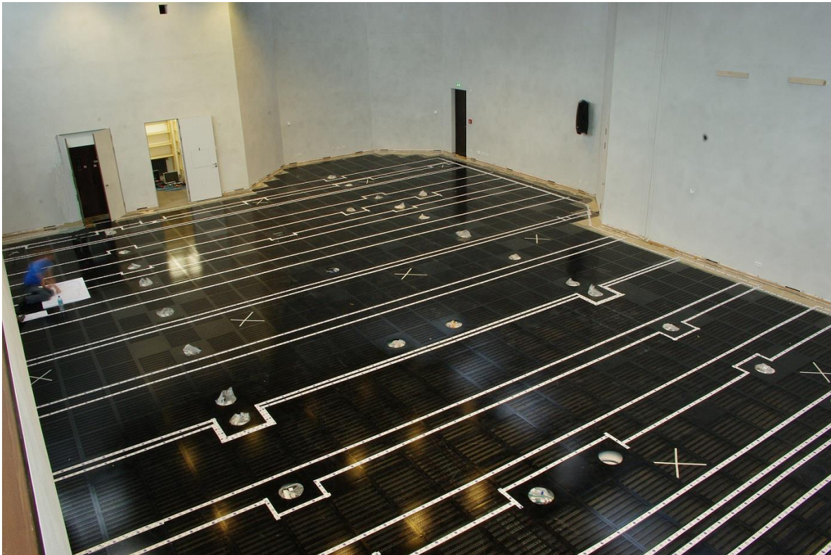
Abbildung 14 : Beispiel für die Verlegung eines Mehrsegment-Schleifensystems mit Phasenschieber ohne Übersprechen auf einem Metallboden
