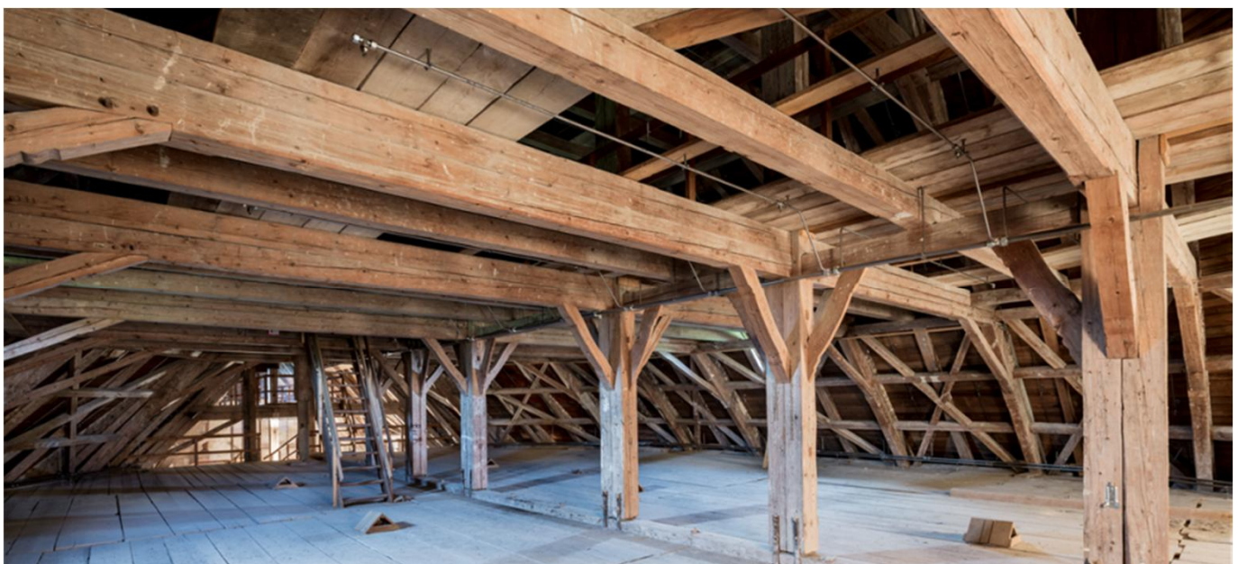
Historischer Dachstuhl mit Löschanlage, untere Ebene – Foto Achim Bunz
