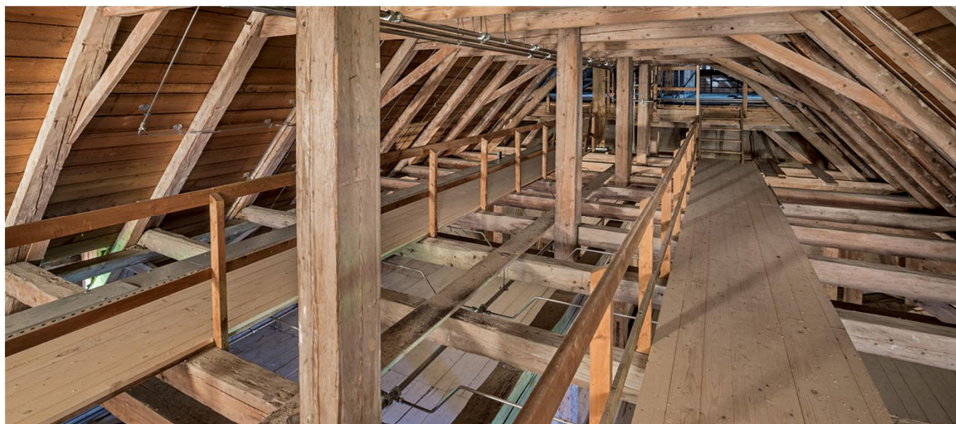
Historischer Dachstuhl mit Löschanlage, obere Ebene – Foto Achim Bunz
