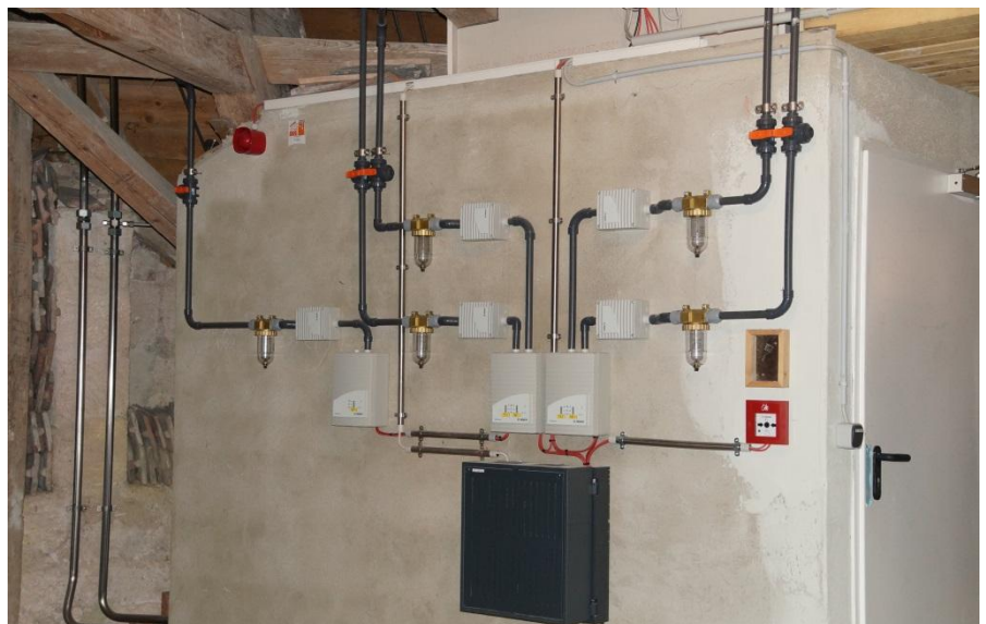
Rauchansaugeanlage Dachraum – Foto Staatliches Bauamt Weilheim
