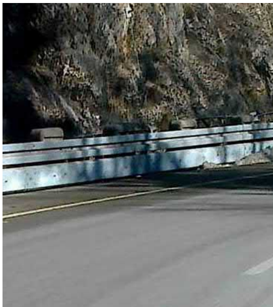
» Abb. 39 Provisorische Unterfahrschutz-Sonderkonstruktion an der Bundesstraße B 23 (Abschnitt 220; Station 3,450)
